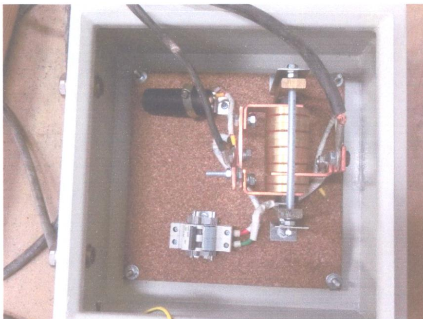
شکل ۲: نحوه اتصال کابل های تزریق جریان به تجهیز تحت تست
