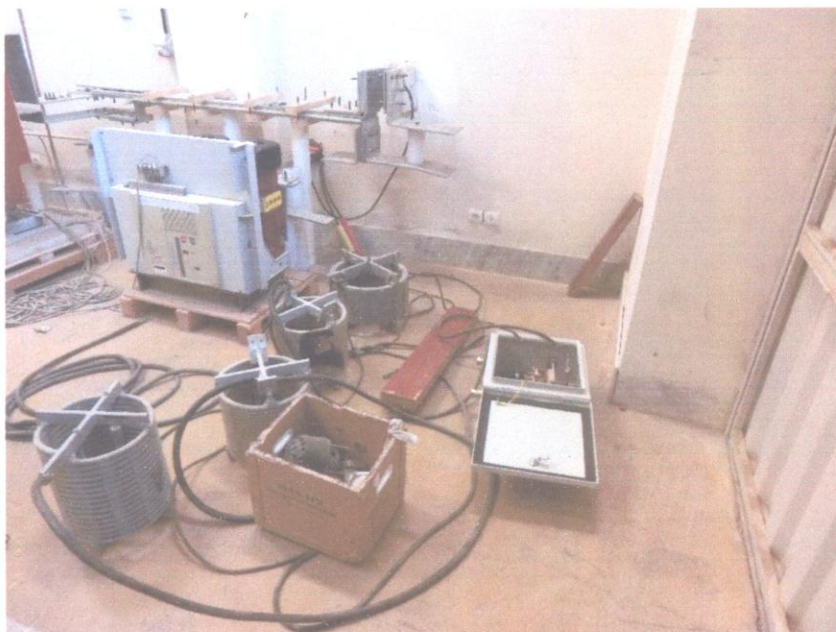
شکل ۳: قرار گیری تجهیز در مدار تست اعمال جریان اتصال کوتاه
